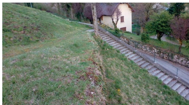
L'escalier menant au chemin n'est pas vraiment sécurisé ; le garde-corps n'est pas aux normes.
