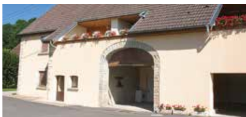
L'ouverture en toiture altère l'existant
