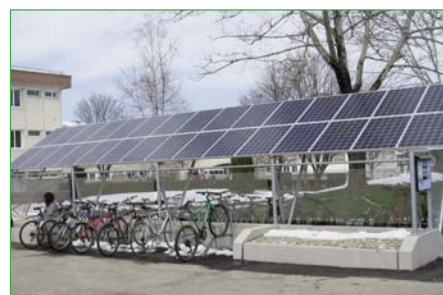
Photovoltaïque - Lycée Xavier-Marmier à Pontarlier (Doubs)
