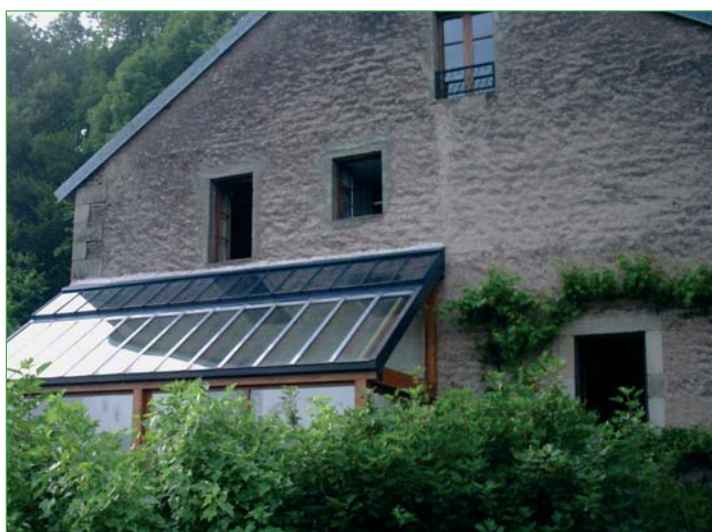
Chauffe-eau solaire à La Lanterne (Haute-Saône)
