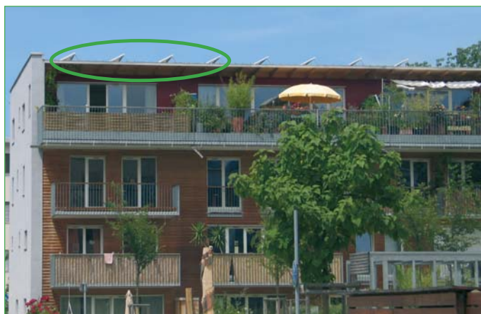
Photovoltaïque à Fribourg (Allemagne)
