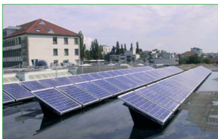
Photovoltaïque - Lycée Montjoux à Besançon
