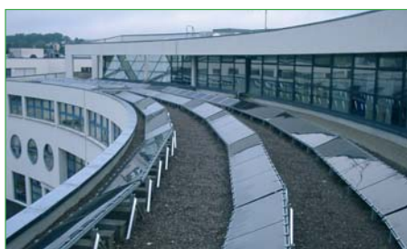
Photovoltaïque - Lycée Aragon à Héricourt (Haute-Saône)
